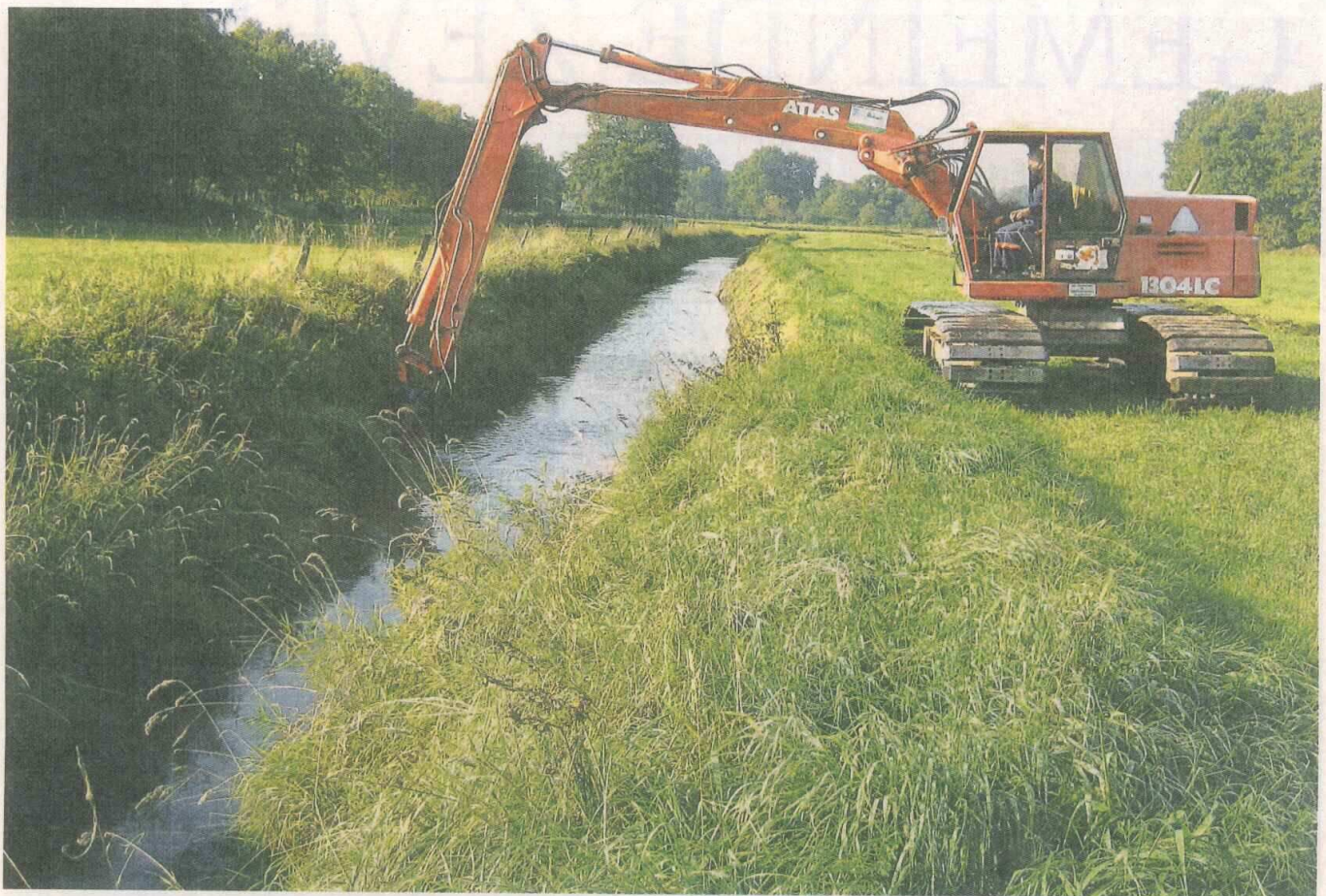
Räumbagger im Einsatz: Für eine gute Durchlässigkeit der naturnahen Gewässer ist eine regelmäßige maschinelle Räumung erforderlich. Archivfoto: ZZ
