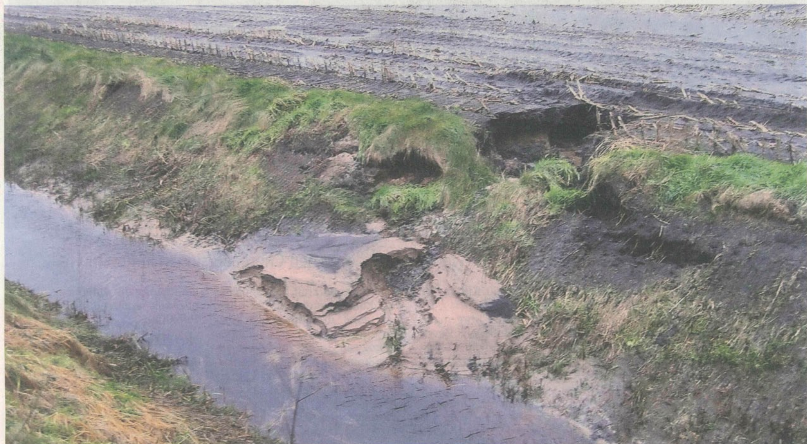
So sollte es nicht sein: Die Böschung des Grabens vor dem Selsinger Moor ist erodiert , weil der Bauer bis an die Böschungskante Mais gepflanzt hat.
