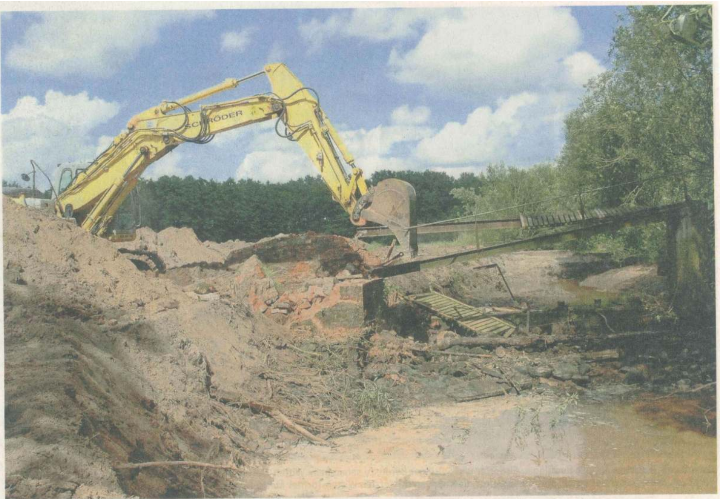
Ein Bagger macht kurzen Prozess: Die leistungsstarke Maschine hat gestern das Ostewehr in der Gemarkung Groß Meckelsen abgerissen. Fotos: jab
