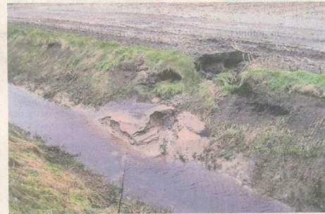
Falsch: Diese so genannte Böschungsauskolkung mit Erosionsrinne durch zu nahe Beackerung entdeckte der Verband im Selsinger Moor. Fotos: bz
