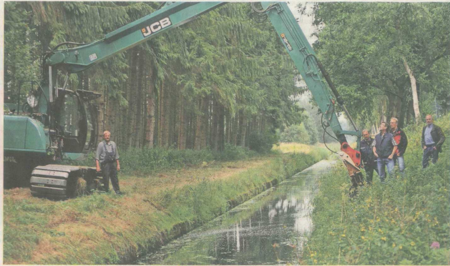
Ortstermin: Vertreter des Unterhaltungsverbandes Obere Oste trafen sich mit Mitarbeitern des Gewässer- und Landschaftspflegeverbandes Teufelsmoor bei den Räumarbeiten am Oste-Hamme-Kanal bei Klenkendorf.
