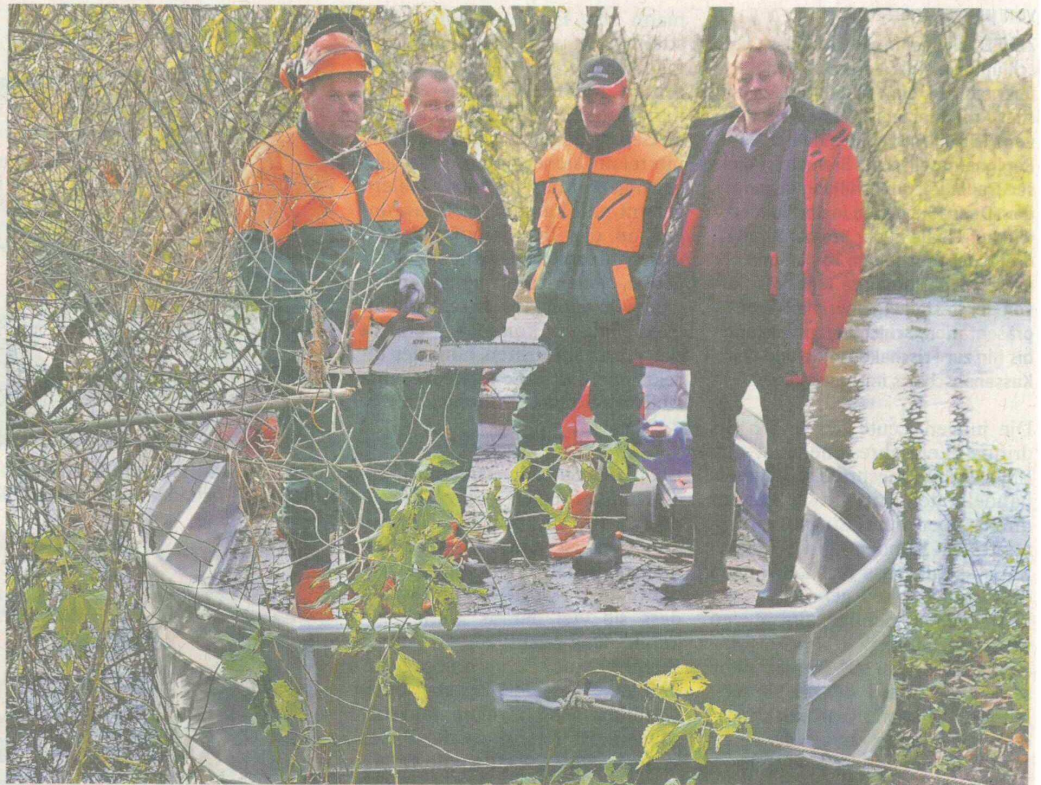
Die Unterhaltung der naturnahen Oste zwischen Brauel und Mintenburg macht es erforderlich, dass die Mitarbeiter von Lohnunternehmer Günter Hausschild (rechts) vom Wasser aus arbeiten. Foto Kratzmann
