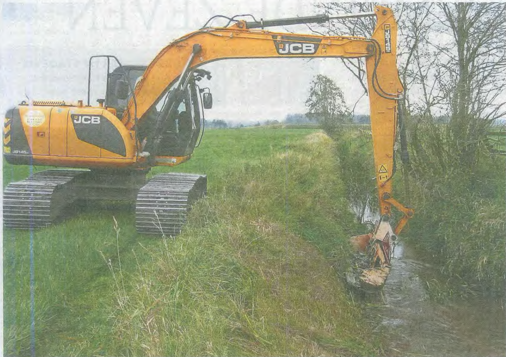
Ein fünf Meter breiter Räumstreifen muss auf alle Fälle frei bleiben: Mähkorbbagger bei der Arbeit an einem Gewässer.
