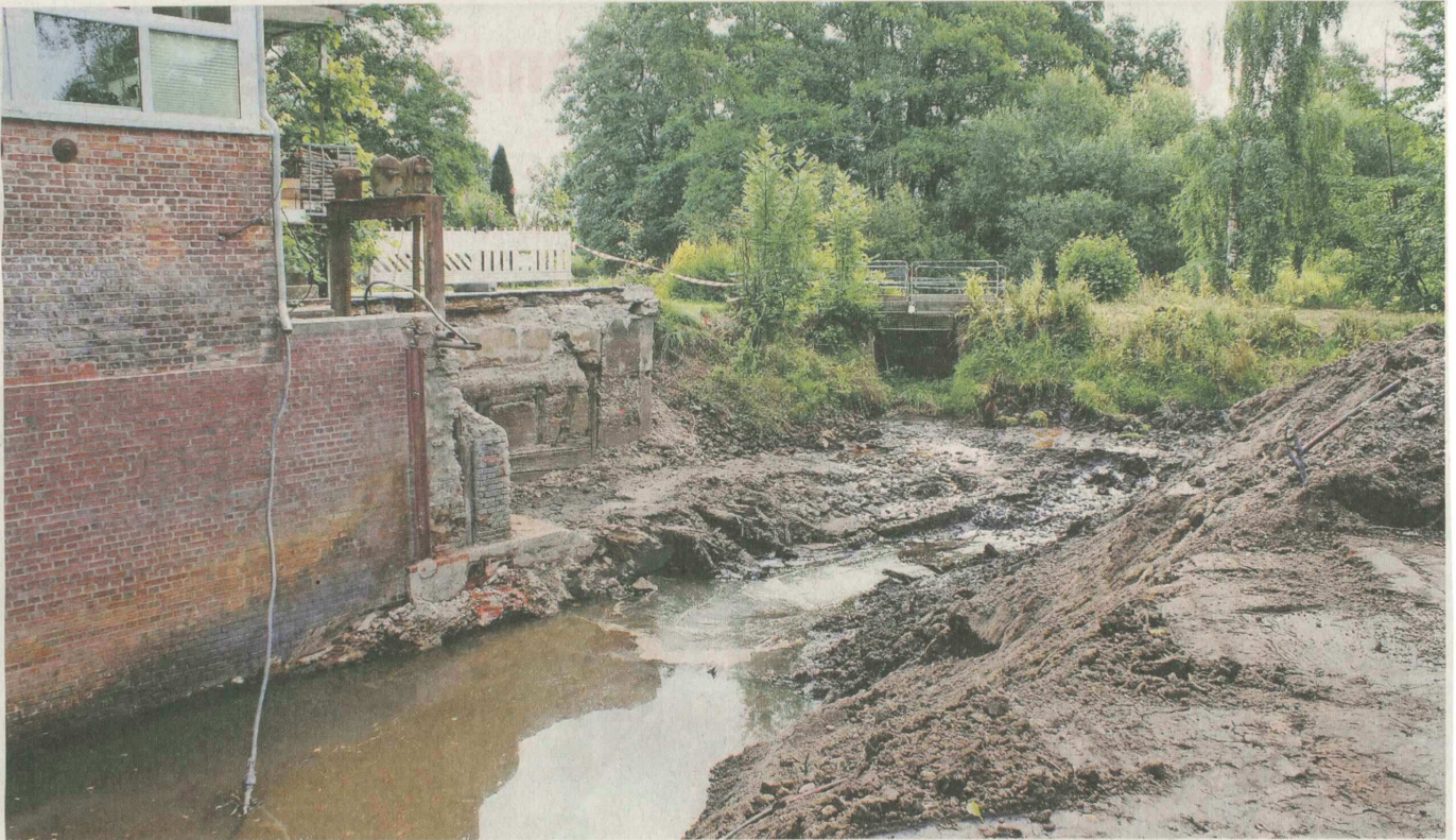
Das Mühlenwehr und die dazugehörige Brücke in Malstedt wurden abgerissen , um Platz für eine Sohlgleite zu schaffen. Vor Beginn der Arbeiten wurde die Fische in diesem Teil der Bever vom Fischereibeauftragten Ernst Peters herausgenommen. Fotos: Bick
