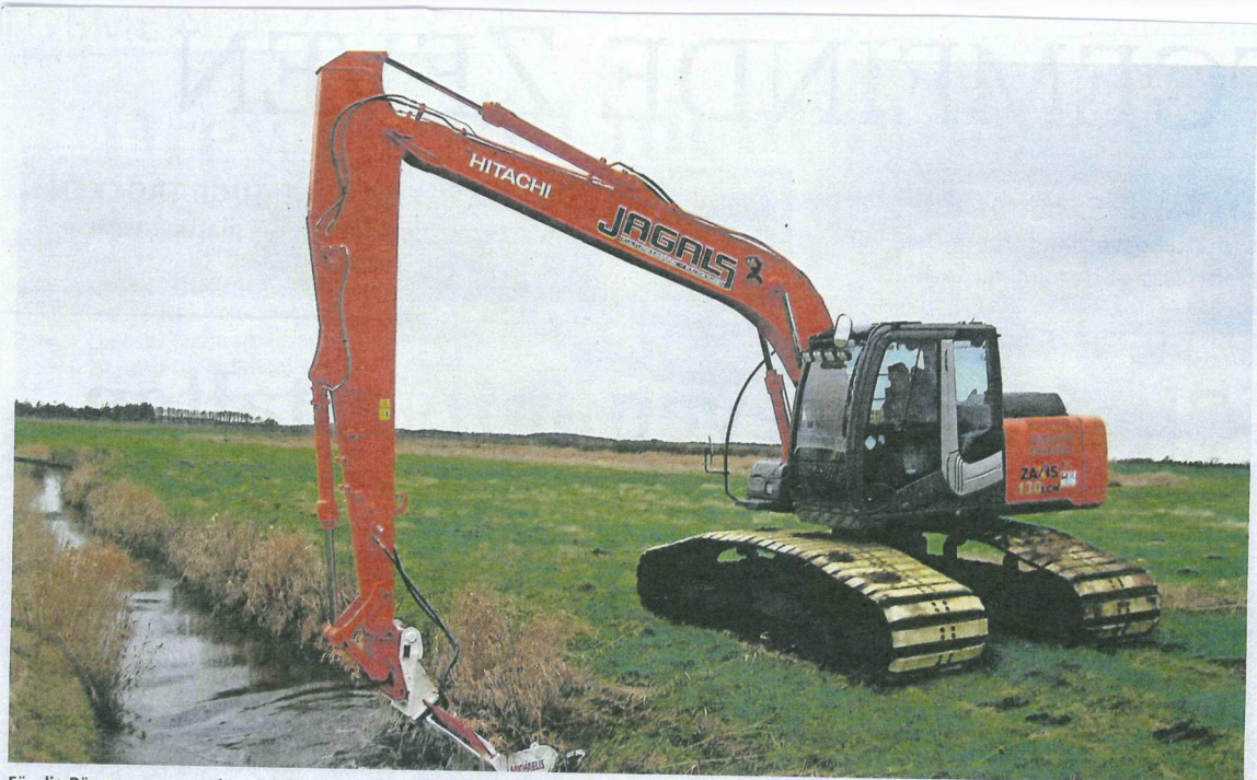
Für die Räumung von rund 500 Kilometer Gewässerlauf stehen dem Unterhaltungsverband Obere Oste 350 000 Euro zur Verfügung. Foto W. Meyer
