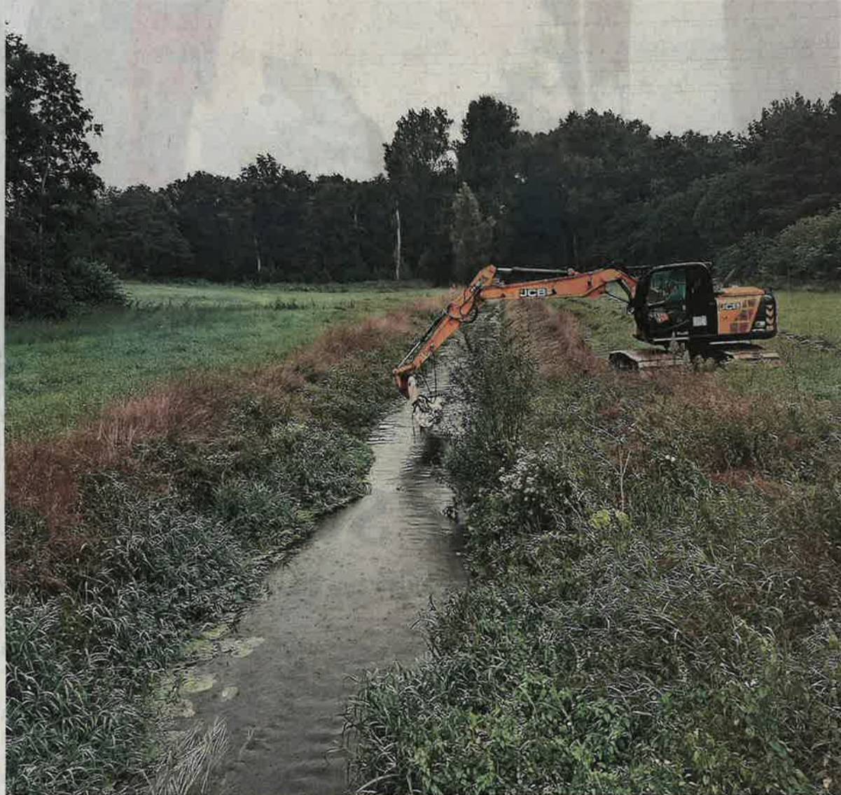
Angesichts zunehmenden Aufwuchses in den Gewässern und Vorgaben einer naturschonenden Räumung hat der Unterhaltungsverband Obere Oste höheren Aufwand zu treiben. Foto: Meyer
